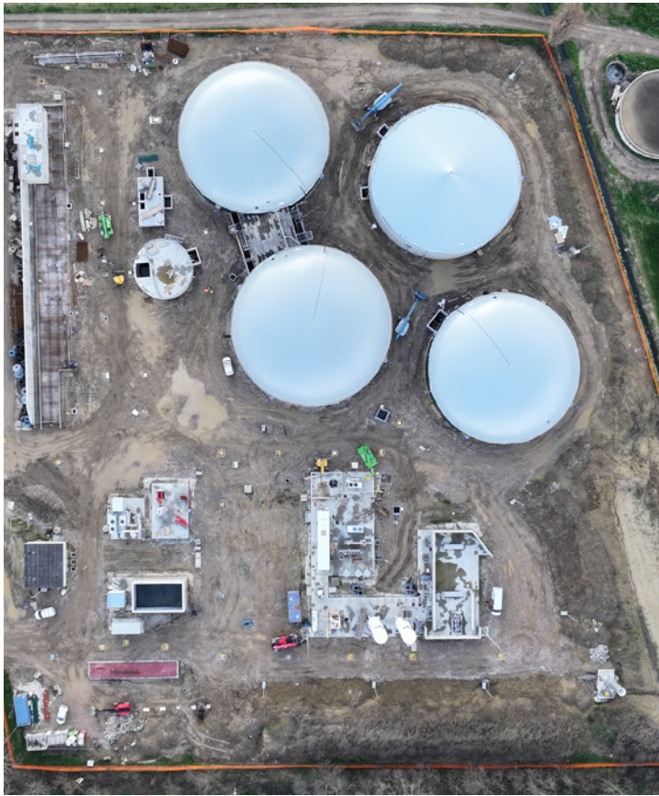
Impianto Biogas, Isso
